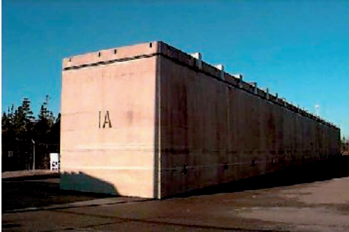
FIG. I-6. LLW storage bunker.
